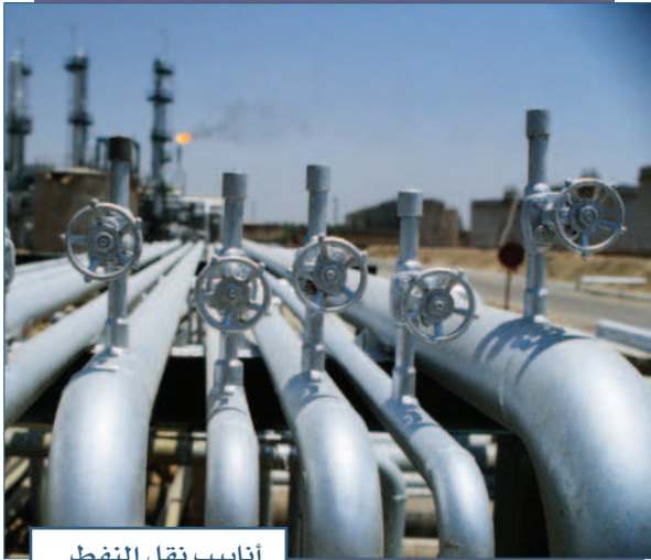
أنابيب نقل النفط
