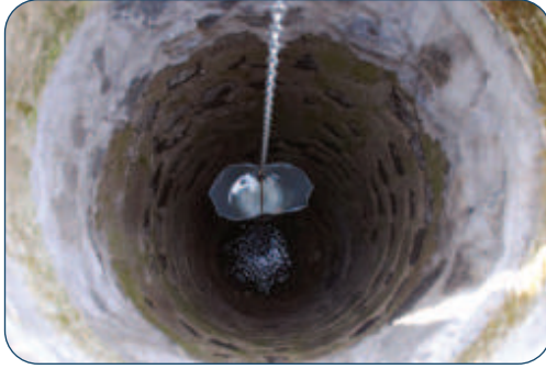
شكل 3-8 آبار المياه الجوفية
